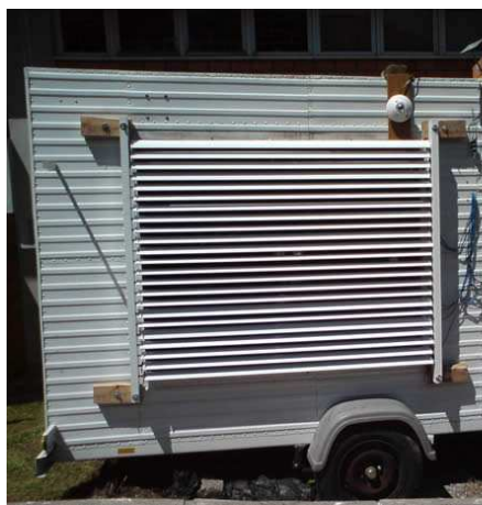
Instalação no calorímetro – Brise horizontal
